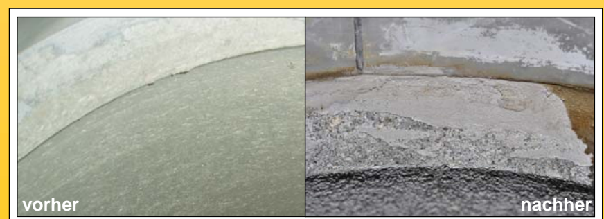
Abb. 5 Oberflächenkorrosion im Betontank (Bildausschnitt mit Deckelöffnung)
